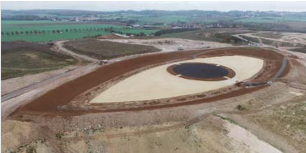
Novembre 2022 | Fin des travaux de terrassement et mise en place de la couche de finition.
