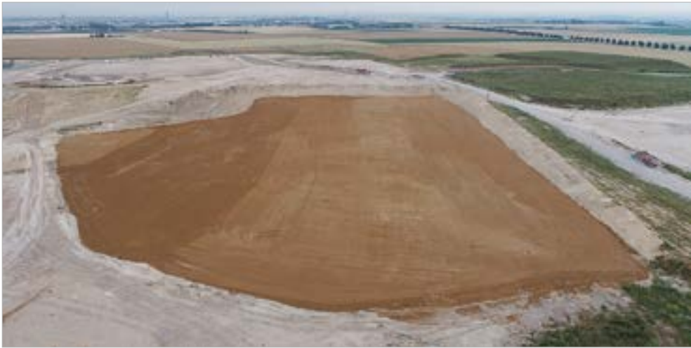
Juin 2022 | Début des travaux et mise en place de la couche inférieure de limon.
